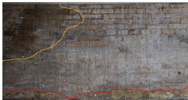
图 9 大佛殿东墙内壁面病害
